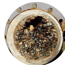
Пример обрастания водозаборной трубы на одной из нефтяных платформ
