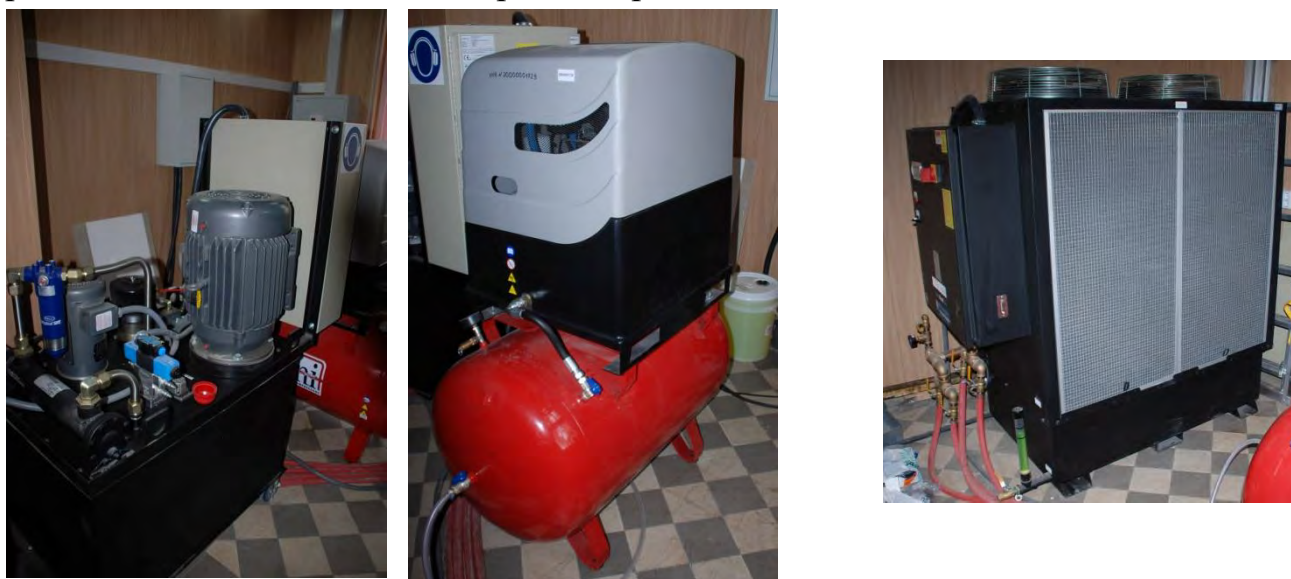
Рис. 8. Маслостанция, компрессор и чиллер (устройство для охлаждения и очистки воды), входящие в комплекс Gleeble-3800
